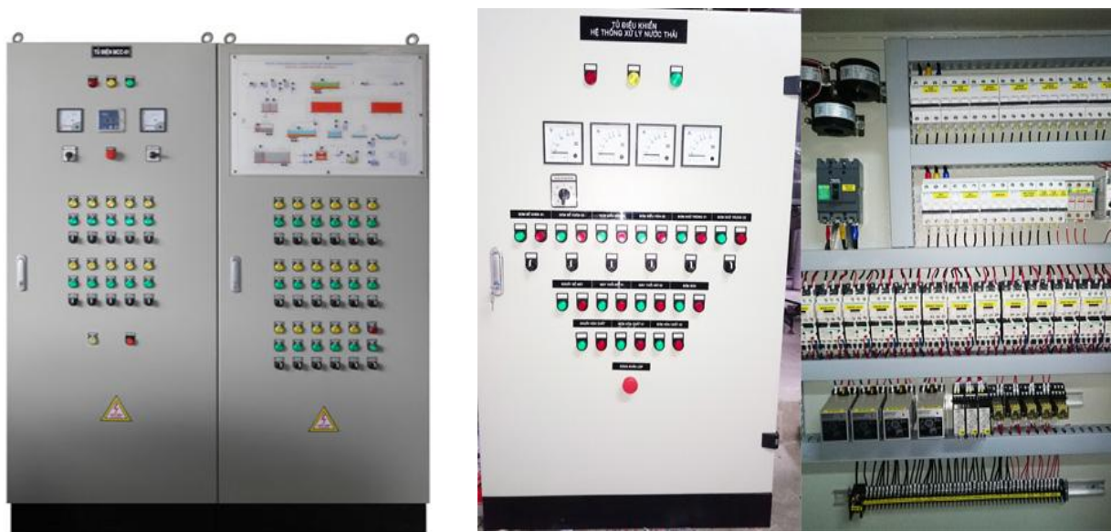
Hình 4.17. Tủ điện điều khiển
